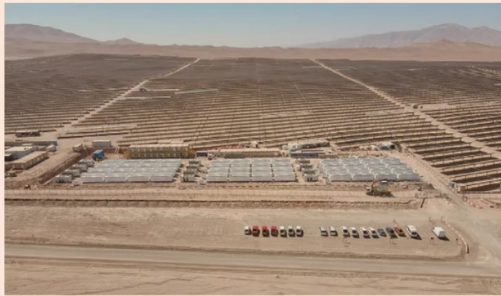
Servicio de Owner's Engineering para proyecto BESS Capricornio, Antofagasta (ENGIE). Capacidad: 48 MW / 264 MWh (96 contenedores de baterías).
