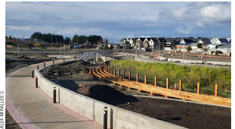
Así se desarrollan los trabajos de colectores de aguas lluvias del estero Llau Llau.
