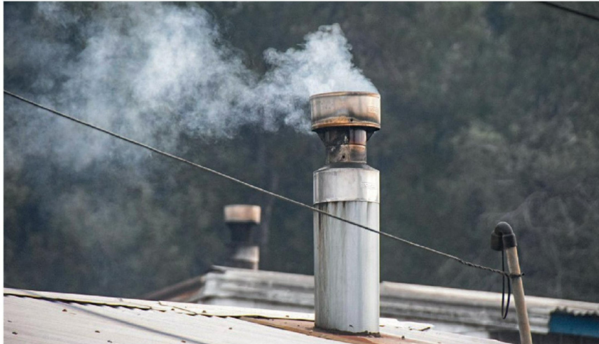
LA MANTENCIÓN DE DUCTO de estufa a leña, una de las principales medidas para prevenir incendios durante el invierno.
