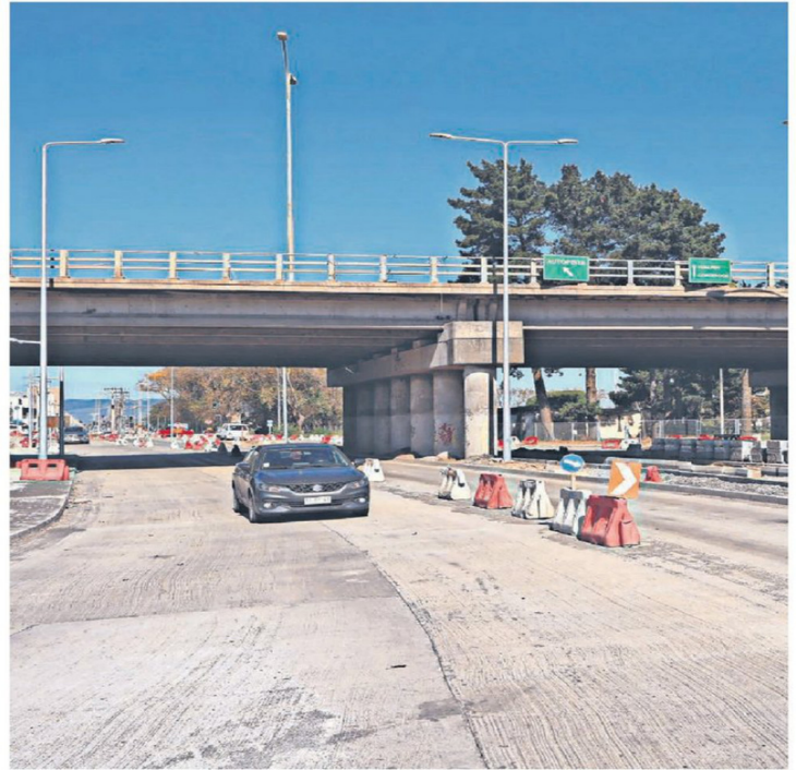
La obra se reactivó en marzo de 2024, tras más de un año sin avance por el quiebre de la exconstructora.
