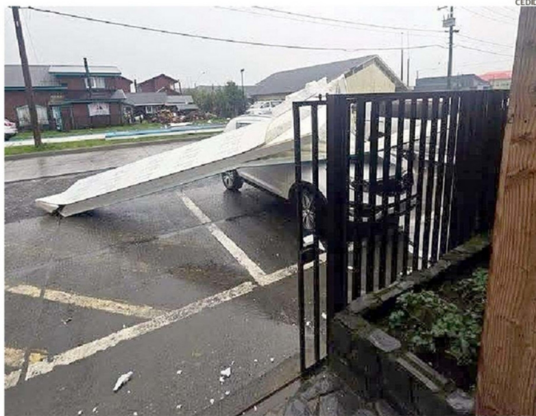
EL MAYOR DAÑO ESTRUCTURAL Y MATERIAL SE VIVIÓ AYER EN LA TARDE EN CHAITÉN.
