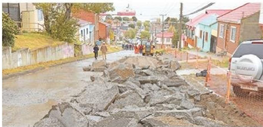
Con el retiro del pavimento dañado en calle Bellavista, entre Avenida España y Almirante Señoret, se iniciaron las obras de reposición del deteriorado paño de dicha calzada.
