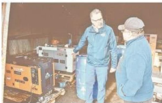
El generador que abastece de electricidad a la Escuela Puerto Toro ya se encuentra en plena operación.
