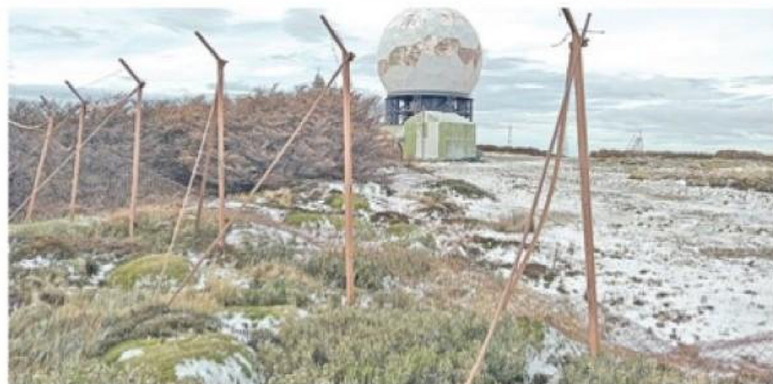
Fotografía del cerco por el lado norte del recinto, con su malla en el suelo.
