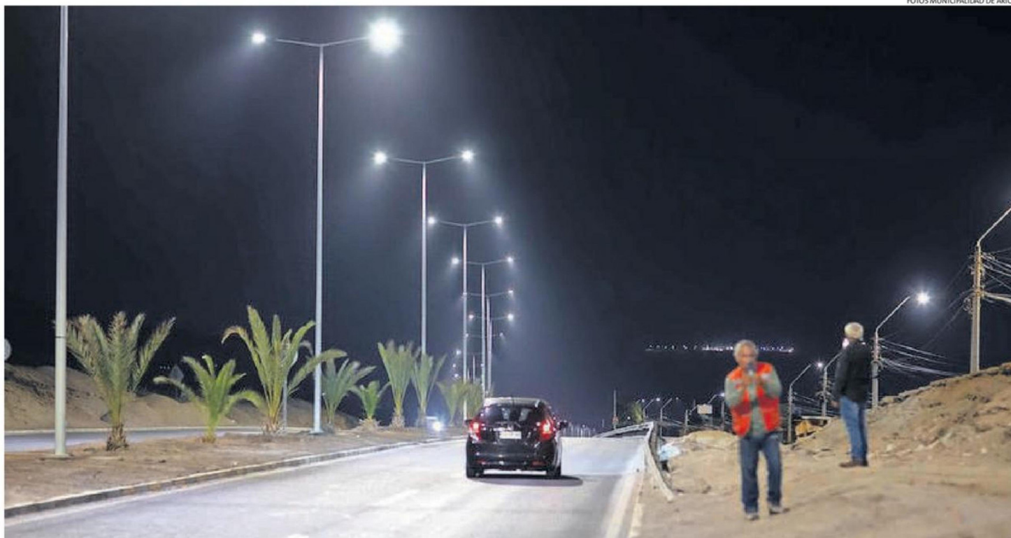
EL PROYECTO, FINANCIADO POR EL GOBIERNO REGIONAL, CONTEMPLA UNA INVERSIÓN SUPERIOR A LOS $1.407 MILLONES E INCLUYE LA INSTALACIÓN DE 168 POSTES Y 336 LUMINARIAS LED.
