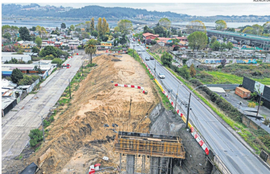
OBRAS PARALIZADAS EN EL PUENTE ESMERALDA, QUE UNE LA COSTANERA NORTE DEL BIOBÍO CON EL CENTRO DE CONCEPCIÓN.
