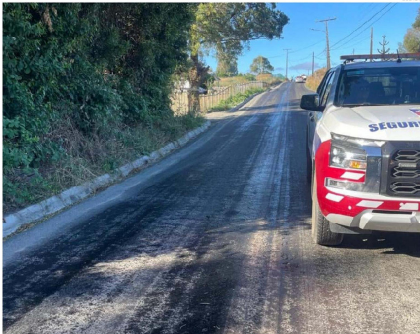
A PRINCIPIO DE AÑO UNA OLA DE CALOR LEVANTÓ PAVIMENTO Y AFECTÓ A CAMINOS EN DALCAHUE.
