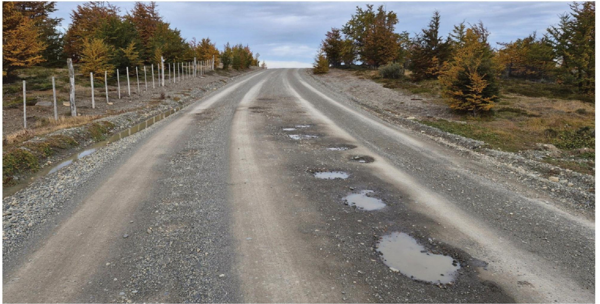
LAS LABORES DE MANTENCIÓN en la red vial de la región permitirán asegurar la continuidad del servicio en distintos caminos.
