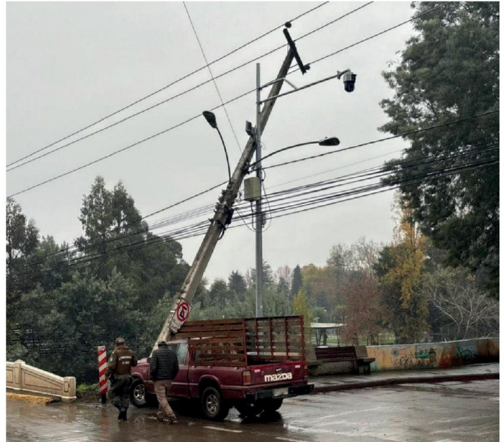
EN MULCHÉN SE REGISTRÓ un accidente de tránsito, lo que obligó a la reposición de un poste en el acceso a la ciudad.
