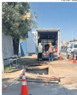
AFECTAN REDES SUBTERRÁNEAS.
