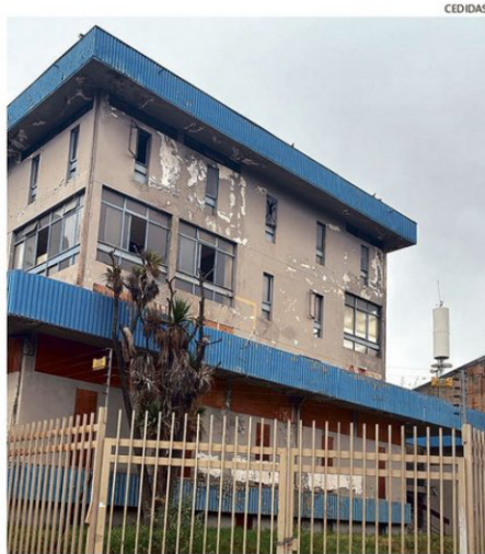
VECINOS ASEGUAN QUE EL ABANDONO DEL EDIFICIO HA GENERADO INSEGURIDAD EN EL SECTOR.
