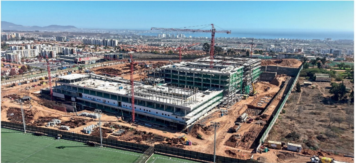
Hoy la presencia femenina en las obras del Hospital de La Serena supera el 33% de las personas contratadas por ACCIONA en este proyecto. Fotos: ACCIONA.
