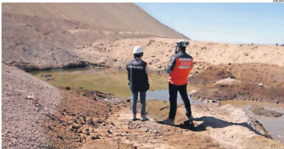
LAS FILTRACIONES EN LA AUTOPISTA A LA ALTURA DEL KILÓMETRO 1.405 COMENZARON A EVIDENCIARSE EN EL AÑO 2020.
