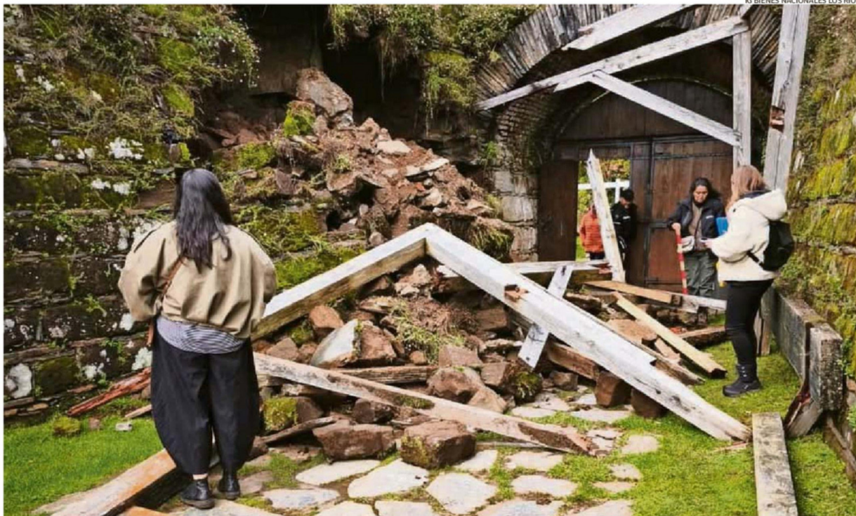
PARA LAS PRÓXIMAS SEMANAS SE ESPERA LA VISITA DE EXPERTOS QUE LEVANTARÁN INFORMACIÓN TÉCNICA SOBRE EL DAÑO A LA ESTRUCTURA.
