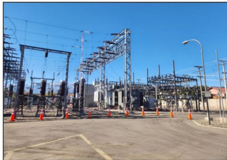
Visitan subestación eléctrica en Los Andes.
