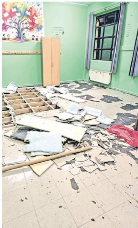
Desde el jueves pasado, y durante todo el fin de semana, trabajó la empresa de mantención del Slep para reparar la sala de clases del séptimo B de la Escuela Bernardo O'Higgins.
