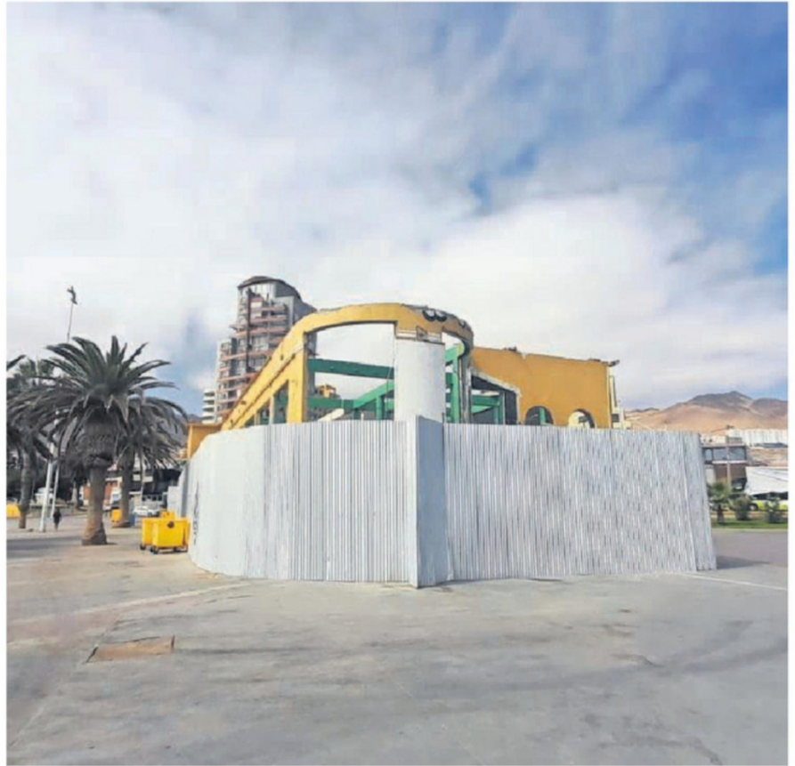
EL EDIFICIO SE ENCUENTRA CERCADO Y EN AVANZADO ESTADO DE DESMANTELAMIENTO.
