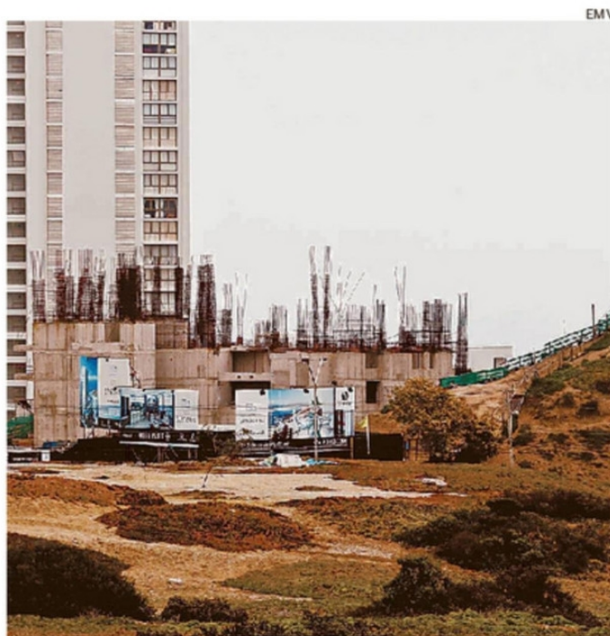
LA DOM CONSTATÓ EN TERRENO EL GRAVE DETERIORO DEL PROYECTO.
