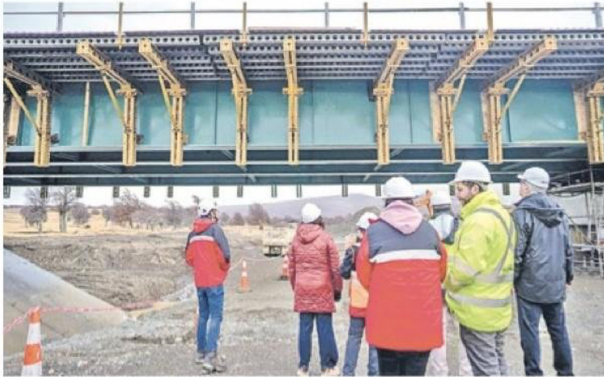
La obra tendrá un costo de $24 mil millones. Considera 4 kilómetros de mejoramiento de sus accesos, rectificando la curva y contracurva existente en la Ruta 9.
