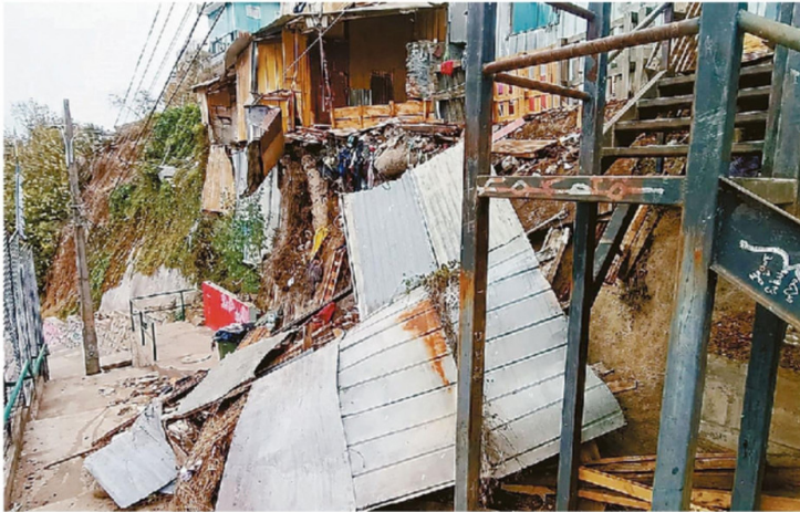
DESPRENDIMIENTO OCURRIÓ DE SÁBADO PARA DOMINGO, DURANTE LA MADRUGADA.
