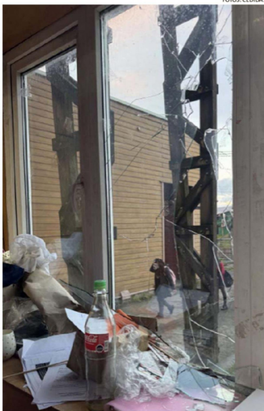
DAÑOS EN UNO DE LOS VENTANALES DEL LICEO POLITÉCNICO.
