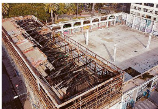
AYER HUBO UN INCENDIO EN EL SITIO DONDE ESTABA EL UNIMARC.
