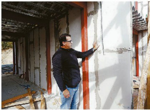
ERIC LAGOS DICE SENTIRSE DECEPCIONADO POR OBRAS DE CONSTRUCTORA.
