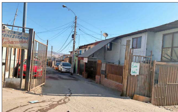
INTERVENCIÓN. — El proceso de demolición y desalojo, que se realizará en cuatro etapas, involucra recursos por $10 mil millones.
