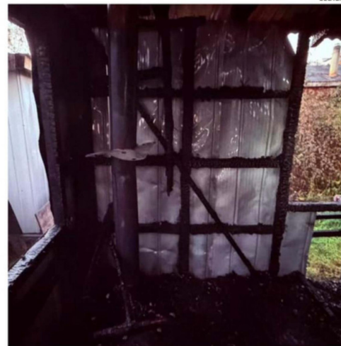
COMPLETAMENTE DESTRUIDA RESULTÓ UNA VIVIENDA.
