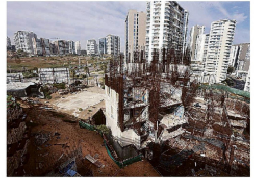
DOM ADVIRTIÓ EN TERRENO GRAVE DETERIORO ESTRUCTURAL DE OBRAS.
