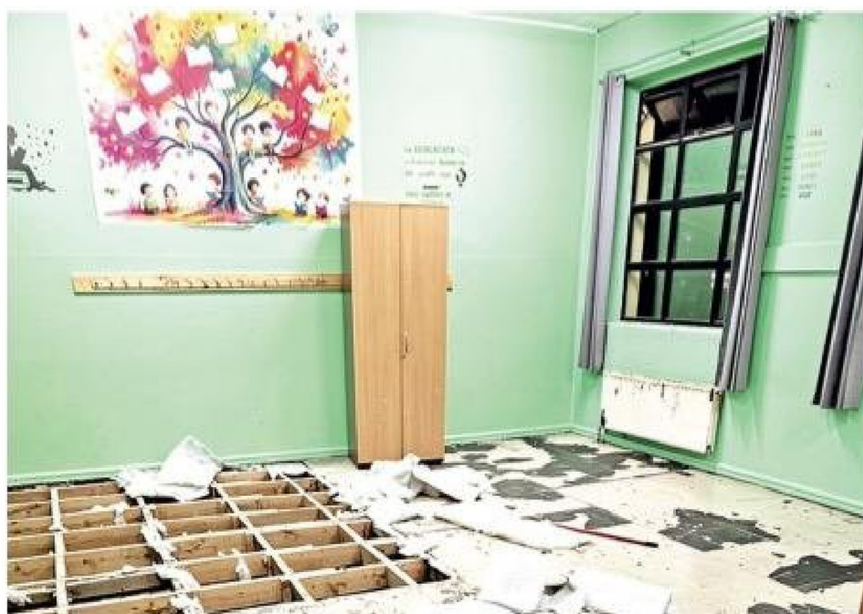
Hace sólo días el Slep reparó el piso de la Sala de 7° básico B, pero sólo respondiendo a la presión de los apoderados, que no enviaron sus hijos a clases durante una semana y clamaron por el arreglo ante prácticamente todas las autoridades locales.
