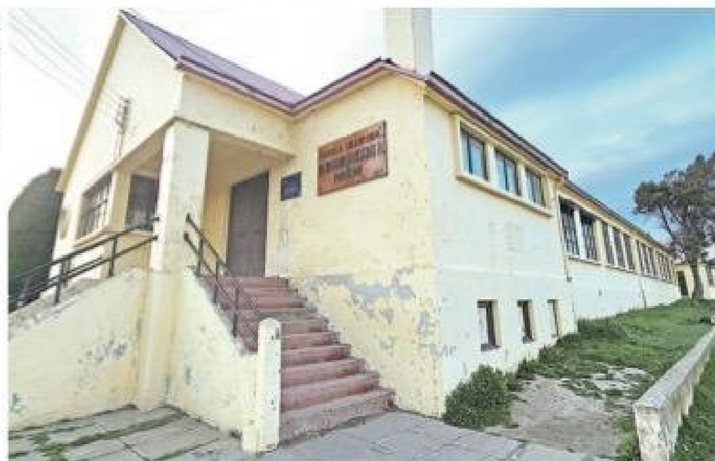
Deterioros, filtraciones de aguas lluvias, pisos rotos, fallas eléctricas por humedad, sobrecarga de alumnos y personal, son parte de las numerosas fallencias de un edificio, construido por la Sociedad Constructora de Establecimientos Educativos en 1946.
