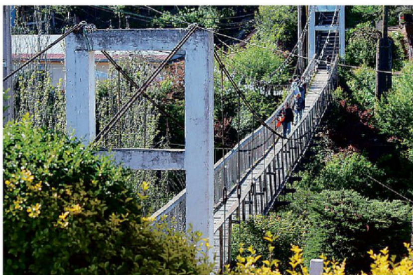
LOS VECINOS ESPERAN QUE ESTE AÑO SE TRABAJE EN LA REPARACIÓN DEL PUENTE COLGANTE.
