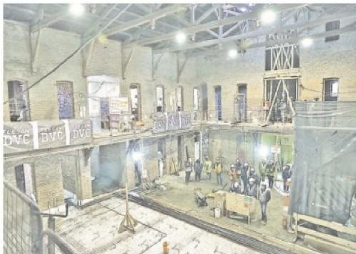
La construcción de la Biblioteca y Archivo Regional en lo que fue el antiguo Presidio.
