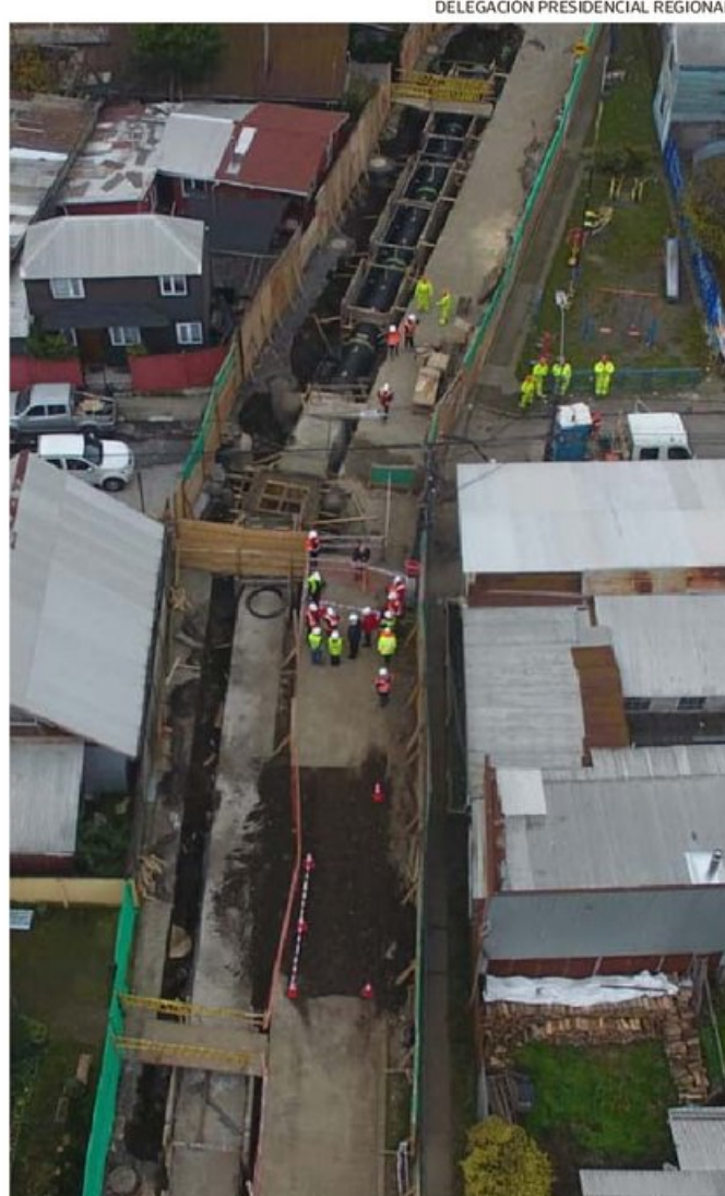
LAS OBRAS TIENEN FECHA DE TÉRMINO DURANTE EL PRIMER TRIMESTRE DEL PRÓXIMO AÑO.
