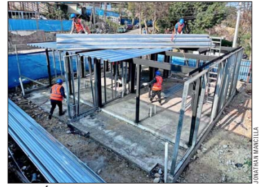
DECISIÓN. — La medida no fue tramitada ante la Dirección de Obras, pues son obras no recepcionadas.
