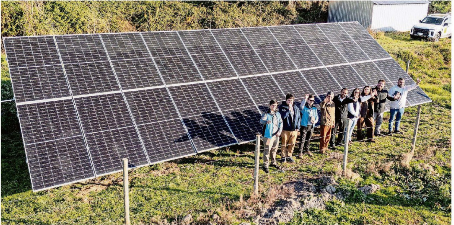
EL GOBERNADOR REGIONAL ÓSCAR CRISÓSTOMO VISITÓ EL PREDIO DEL AGRICULTOR ALFONSO BOBADILLA EN CHILLÁN, DONDE SE IMPLEMENTÓ UNA PLANTA SOLAR FOTOVOLTAICA.
