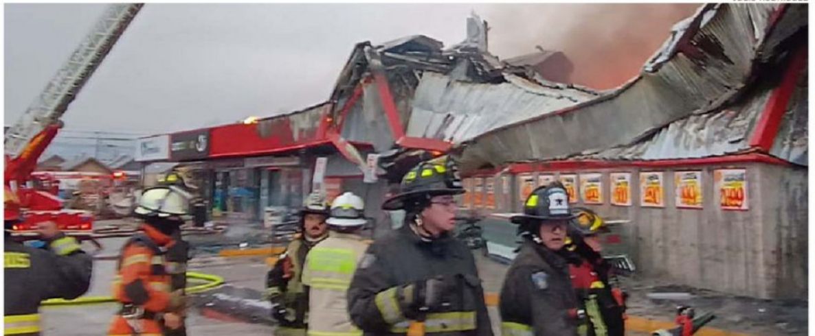
LA ESTRUCTURA COLAPSÓ POR LA VORACIDAD DE LAS LLAMAS. BOMBEROS TRABAJÓ CON ESCALAS TELESCÓPICAS PARA EVITAR LA PROPAGACIÓN.
