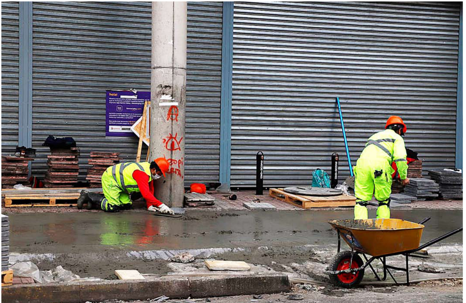
No solamente el Estado pasa malos ratos con la quiebra de Tapusa. Vecinos que deben convivir con obras a medio hacer y contratistas a quienes se les adeudan millones de pesos son parte del drama.
