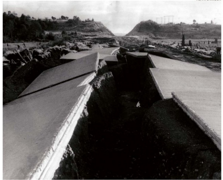
EL ESTADO DE UNA CARRETERA DE PUERTO MONTT REFLEJA LA INTENSIDAD DEL MOVIMIENTO SÍSMICO.
