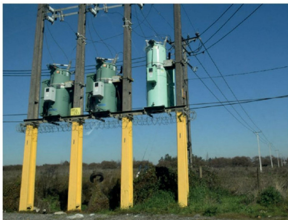
DETALLE DE LA NUEVA POSTACIÓN de hormigón y cables protegidos instalados por Coopelan como parte de su plan de modernización de infraestructura.
