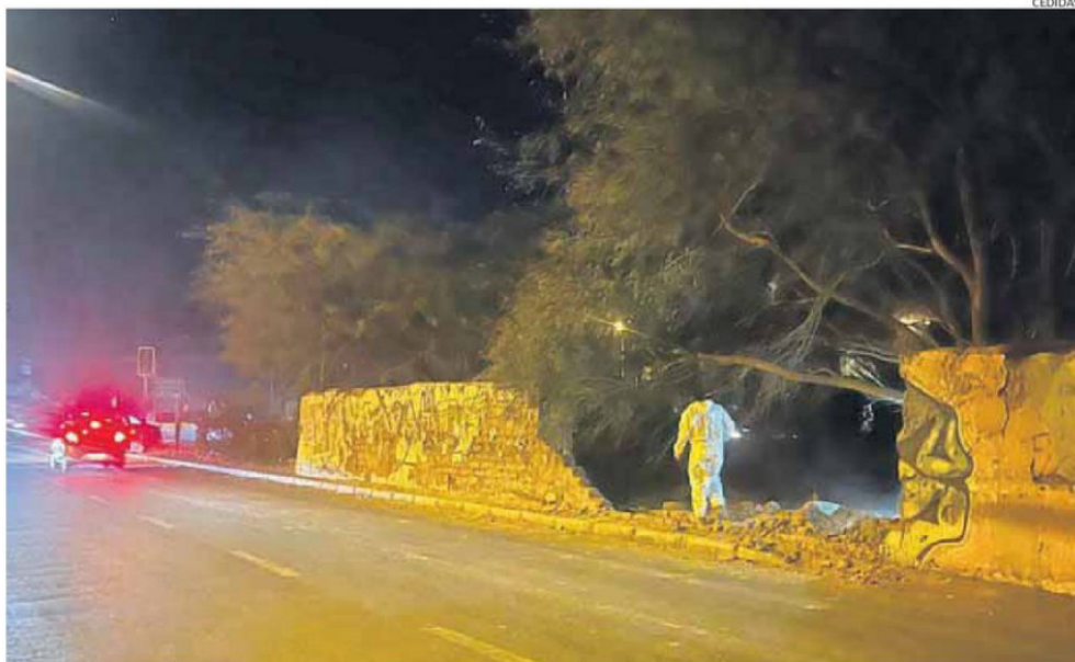
UN MURO SE DESPLOMÓ CERCA DEL PARQUE EL LOA Y FUE UNO DE LOS POCOS DAÑOS EN INFRAESTRUCTURA QUE SE REGISTRÓ TRAS EL SISMO.
