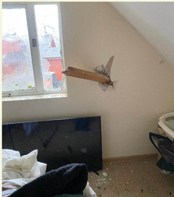
Vecina que residía en calle Los Alpes fotografió un sector de su domicilio donde se evidencia que un trozo de madera (aparentemente la viga de alguna casa) atravesó la pared de su habitación.
