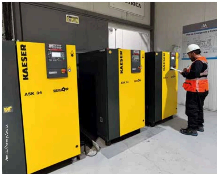
Control energético planta de proceso.
