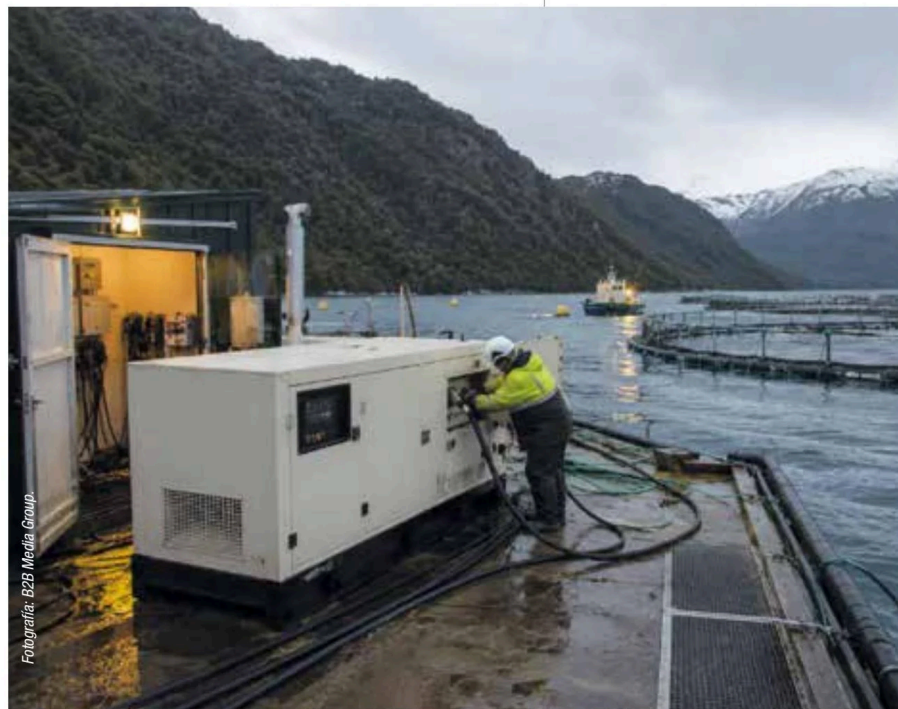
Generadores en operación en salmonicultura.
