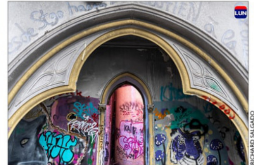
Todas las paredes de la iglesia están rayadas.
