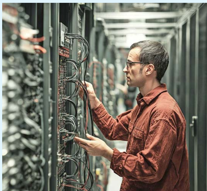
ARAGÓN SE UBICA en el centro de la malla de distribución eléctrica española, lo que reduce el tiempo que tarda un datacenter en conectarse a la red.
