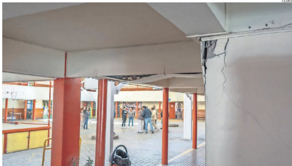
LA ESCUELA VALENTÍN LETELIER FUE UNA DE LAS AFECTADAS EN SU INFRAESTRUCTURA TRAS EL TERREMOTO DEL PASADO LUNES EN CALAMA.
