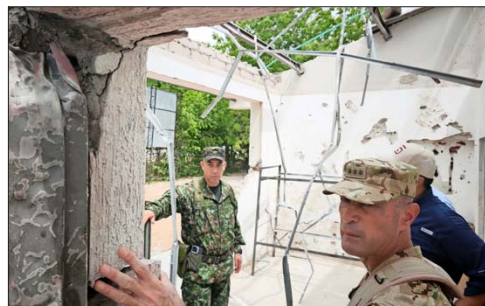
SOLDADOS COLOMBIANOS inspeccionan los daños tras el atentado contra el Batallón de Infantería en Riohacha, La Guajira.
