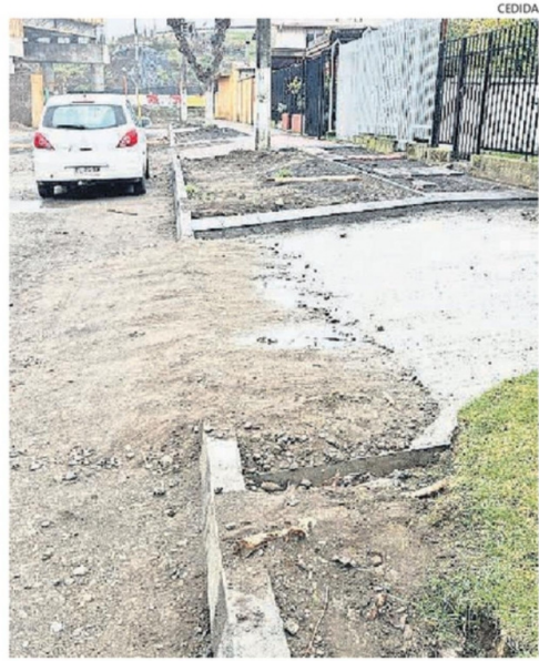
OTRO PROBLEMA ES LA FALTA DE TERMINACIÓN DE LA ACERA.
