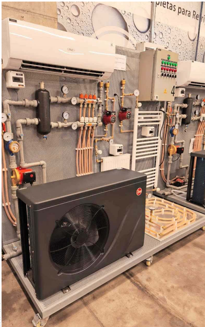
La combinación entre equipos modernos, mejor aislación térmica y automatización está permitiendo reducir el consumo energético en estos sistemas.
